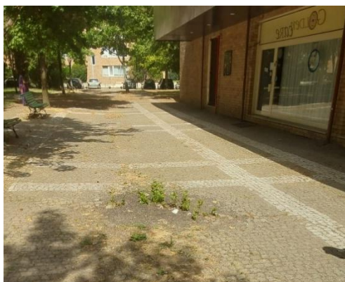
Figura 14 Pavimento levantado, surgimento de espécies invasoras no meio dos pavimentos devido a falta de manutenção Fonte: Fotografia própria em
