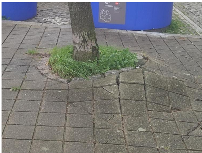
Figura 19 Caldeira com medidas inapropriadas para a espécie em questão, levantamento de pavimento pelo crescimento radicular Fonte: Fotografia própria em agosto de 2025
