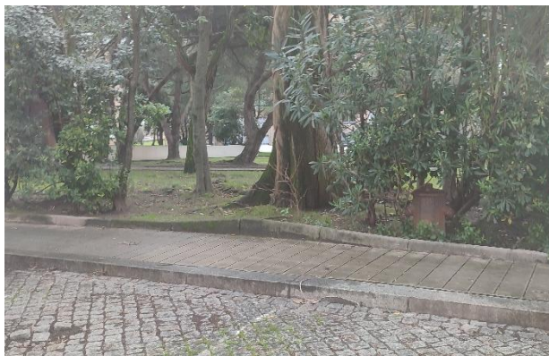
Figura 13 Lancil danificado devido a raízes e falta de manutenção Fonte: Fotografia própria em janeiro de 2025
