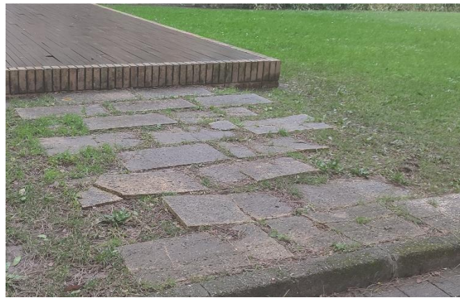
Figura 16 Pavimento secundário degradado devido a falta de manutenção e desgaste natural Fonte: Fotografia própria em janeiro de 2025
