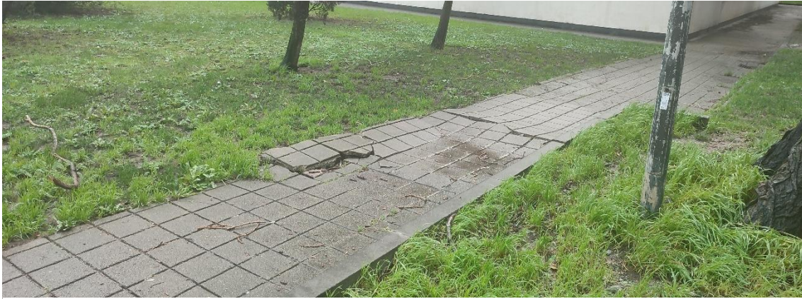
Figura 15 Pavimento degradado e partido, devido as raízes e desgastes, demonstra falta de manutenção Fonte: Fotografia própria em janeiro de 2025
