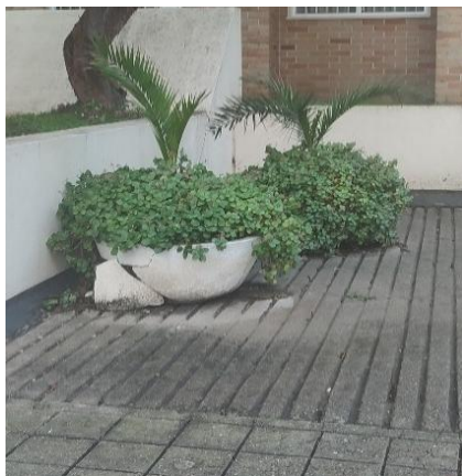
Figura 17 Vasos e canteiros partidos por crescimento das raízes e falta de manutenção Fonte: Fotografia própria em janeiro de 2025
