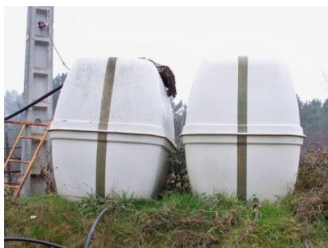
Fotografia 12: Reservatórios de água exteriores.
