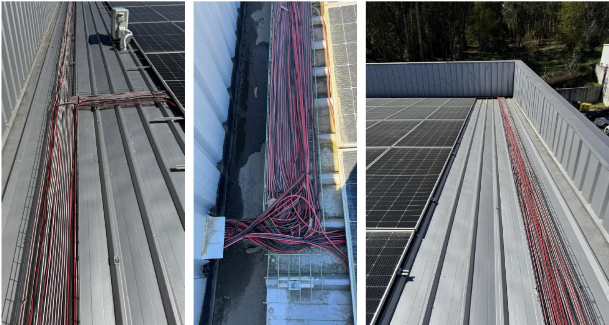
Anexo A. 4 - Exemplo de defeitos encontrados na instalação existente
