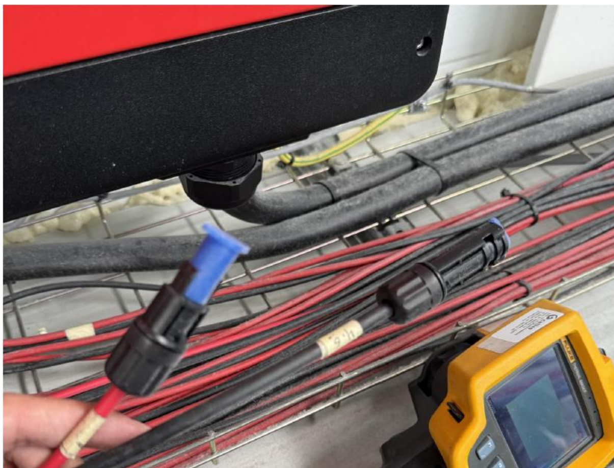
Anexo A. 7 - Exemplo de defeitos encontrados na instalação existente - cabos desconectados
