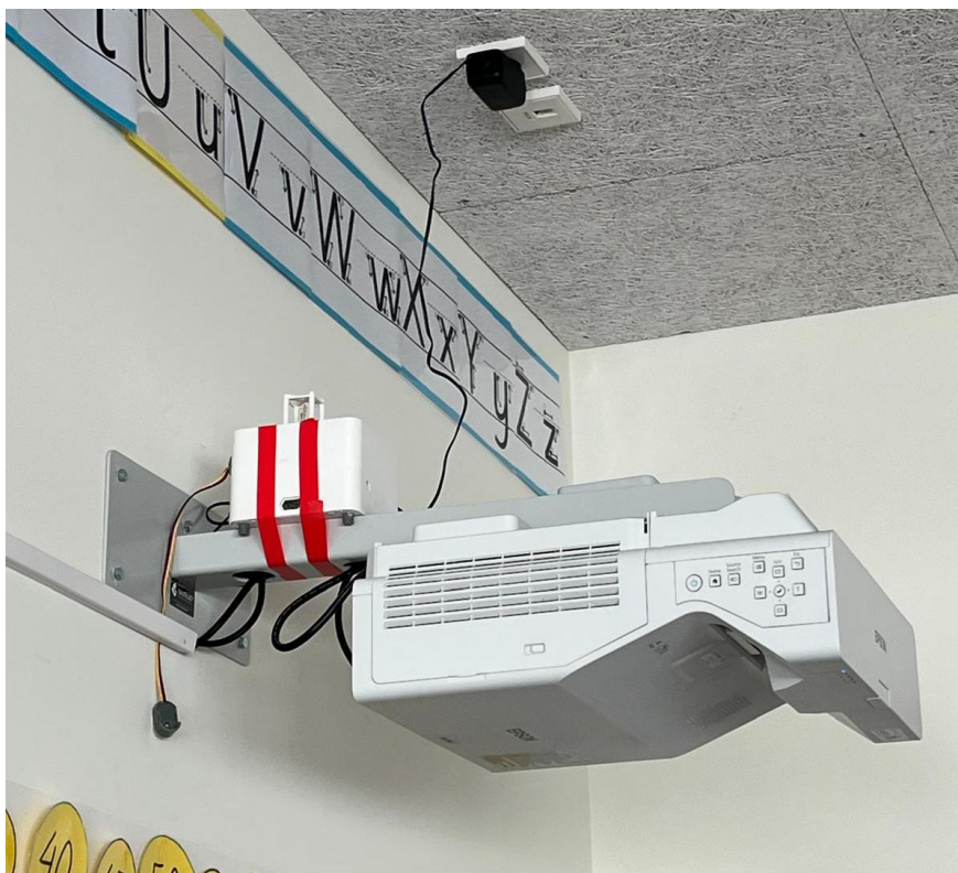
Figura 35- Sensor instalado sobre o projetor multimédia na sala A1.03
