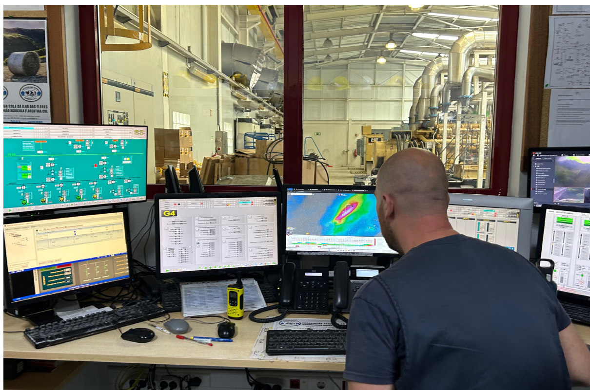
Fig. 8.7 - Sala de comando da Central Termoelétrica da ilha das Flores, setembro de 2023.
