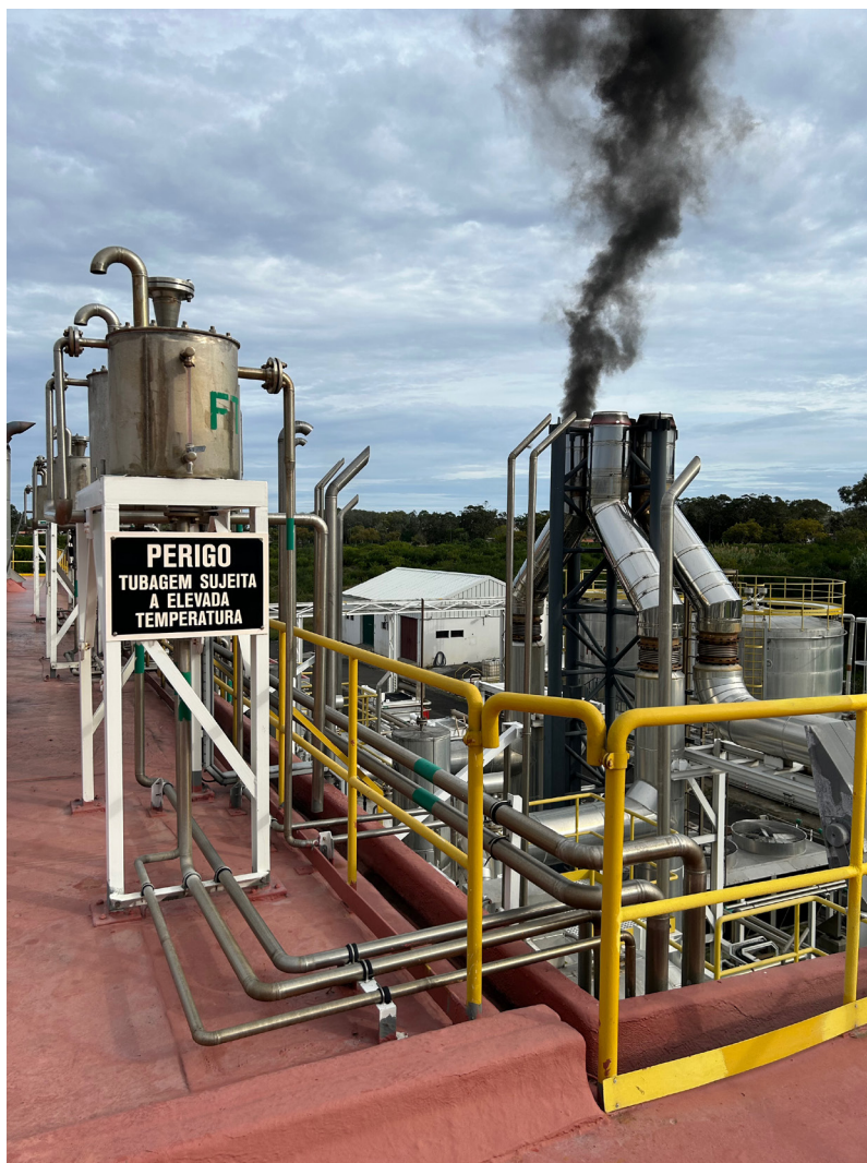
Fig. 8.10 - Central Termoelétrica do Aeroporto, ilha de Santa Maria, outubro de 2023.
