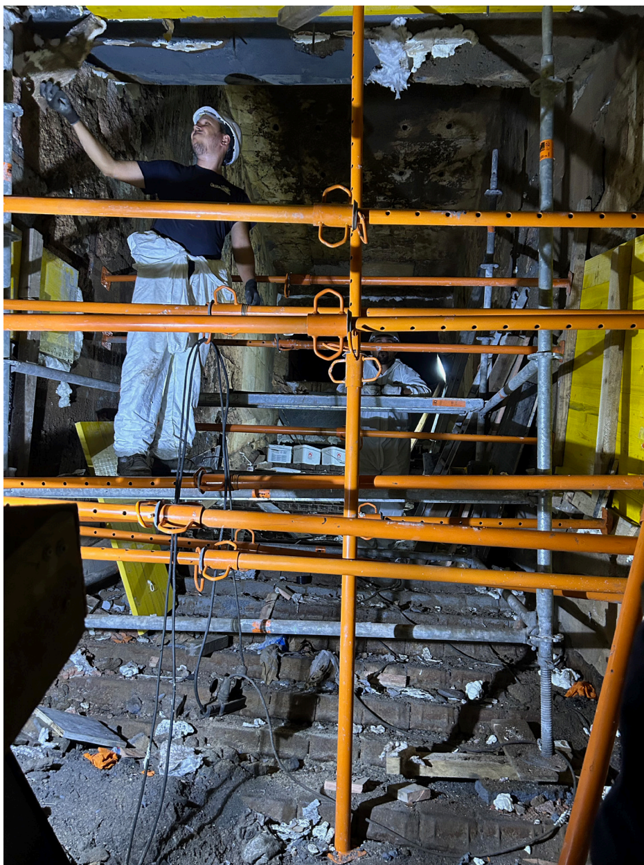
Fig. 10.10 - Interior do forno, instalações da TERAMB, ilha Terceira, outubro de 2023.
