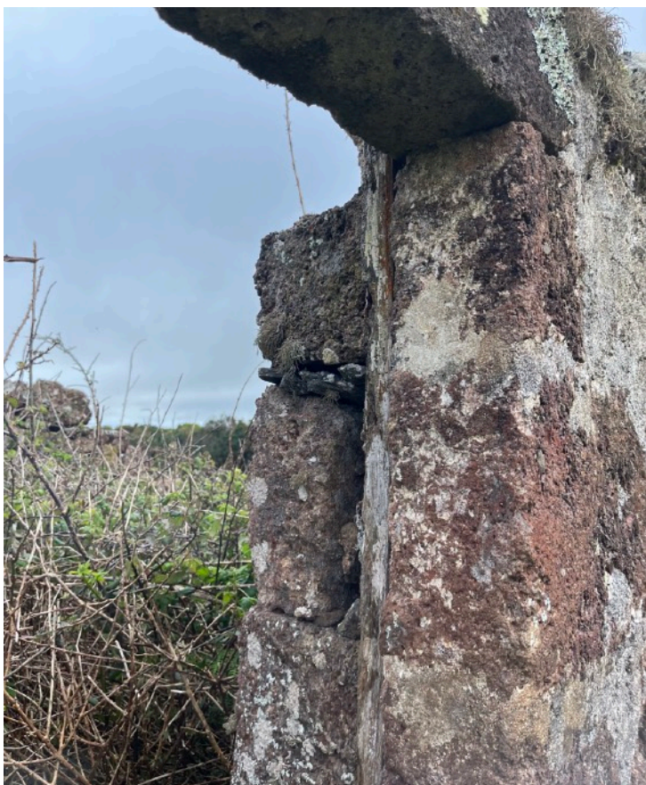
125. Detalhe do rasto da caixilharia em madeira da porta.
