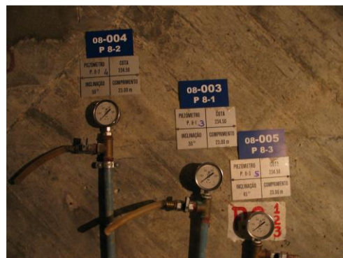
Figura 14 - Manómetros de um leque piezométrico (da Mata, J.T.C., 2007).
