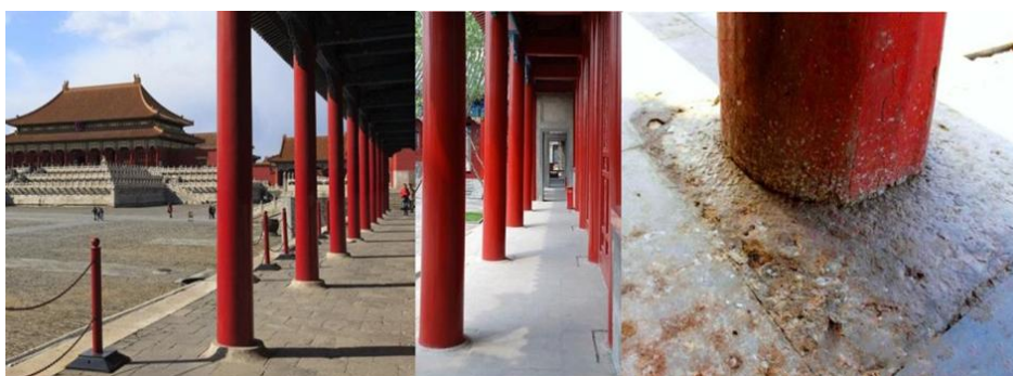
Figura 12 – a) Base sem degradação; b) Base semi degradada; c) Base muito degradada [52].
