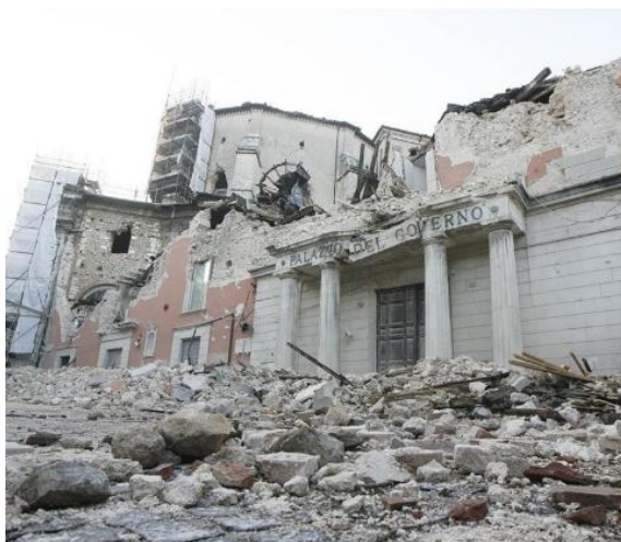
Figura 2 - Danos gerais causados pelo sismo de L'Aquila, retirado de Folena (2018)
