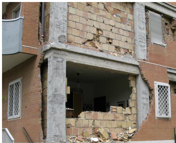
Figura 3 - Danos sobre paredes em alvenaria causados pelo sismo de L'Aquila, retirado de Miyamoto (2013)
