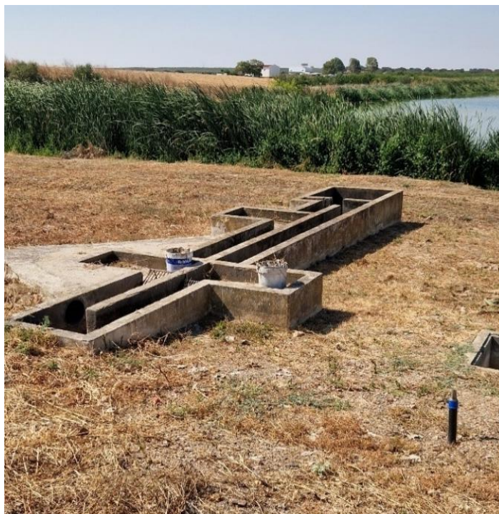
Figura 12 – Obra de entrada ETAR Penedo Gordo (Fonte: Hidrofunção – Consultores de Engenharia, Lda.)
