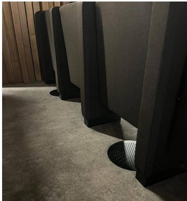
Figura 4.13– Grelhas do sistema AVAC localizados sob os assentos da plateia do Teatro Jordão. [foto da autora]
