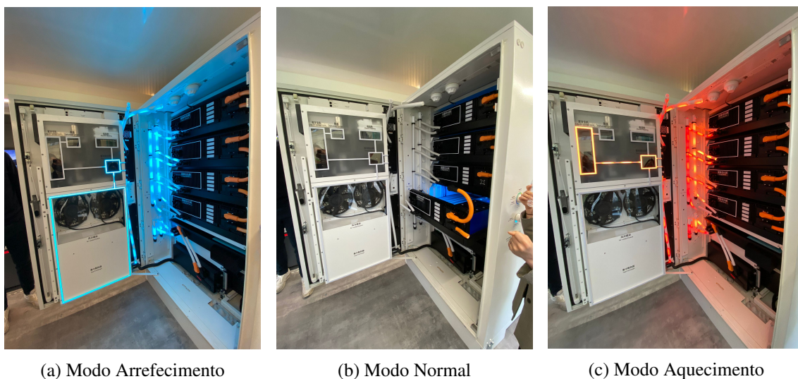
Figura 2.10: Bateria Industrial Huawei LUNA2000-215-2S10 em Diferentes Modos de Operação. (Fotografias Tiradas num Evento Organizado Pela Empresa Krannich Solar )
