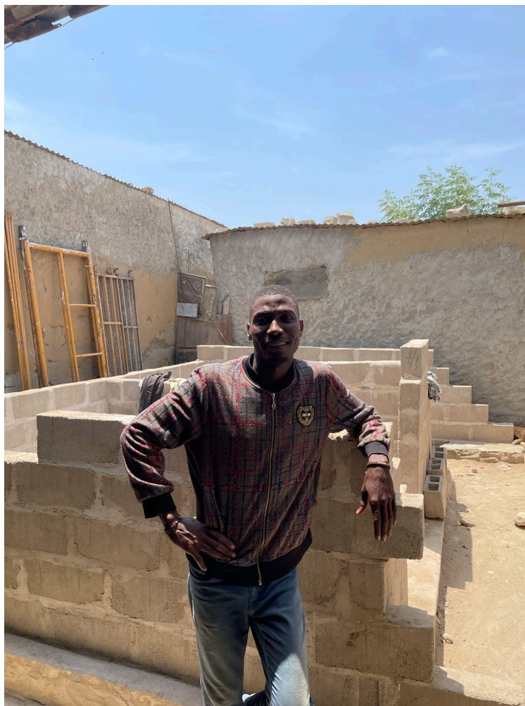
Figura 77: Faustino e a sua obra inacabada a 1,5m do chão.
