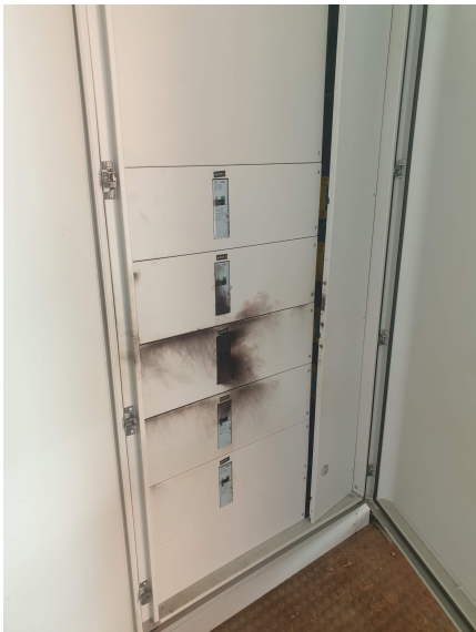
Figura 5.4: Danos causados pela explosão de um disjuntor
