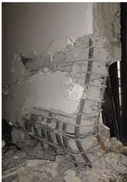
Figura 18 - Encurvadura lateral de uma parede [5]
