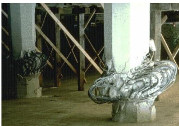
Figura 3 - Rotura de um pilar devido à falta de ductilidade [2]
