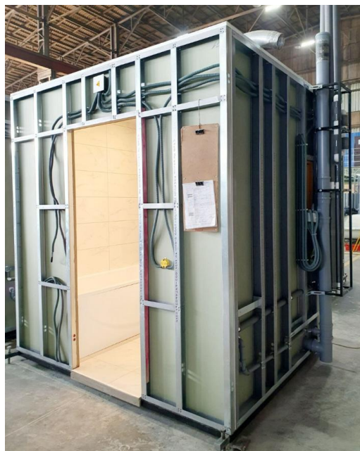
Figura 12 - Instalação elétrica numa casa de banho pré-fabricada, evidenciando a cablagem e a distribuição de circuitos elétricos [34].
