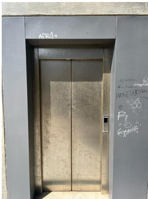
Figura 42 - Elevador avariado e usado para maus fins.
