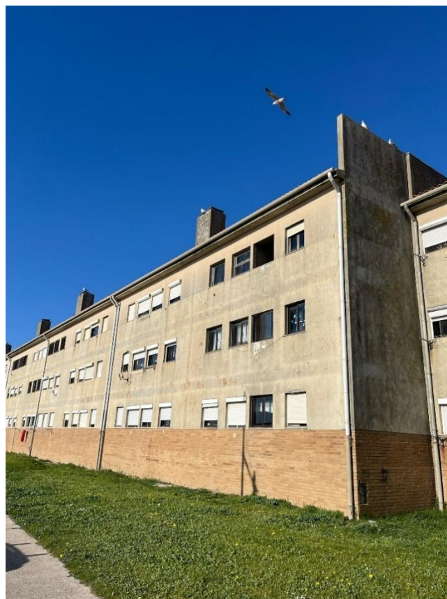
Figura 39 - Apartamentos em estado de degradação.
