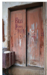
Imagem 30, anomalia nº 45 e 46
