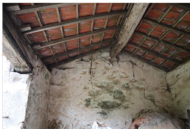
Imagem 31, anomalia nº 1 e 5
