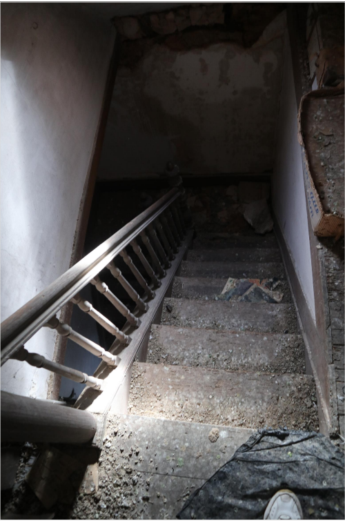
Imagem 66, anomalia nº 13 e 36
