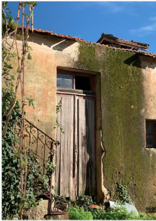
Imagem 19, anomalia nº 1 e 46
