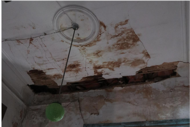
Imagem 94, anomalia nº 25 e 11
