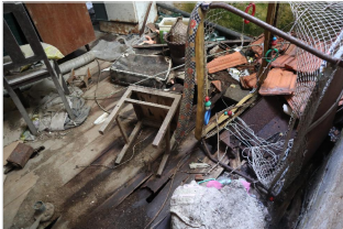
Imagem 38, anomalia nº 6 e 20
