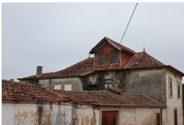
Imagem 29, anomalia nº 1, 3 e 27
