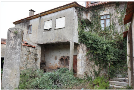
Imagem 17, anomalia nº 2, 4, 5 e 40
