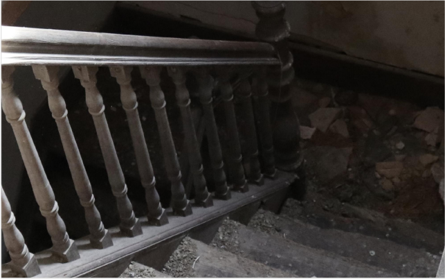
Imagem 64, anomalia nº 33 e 34
