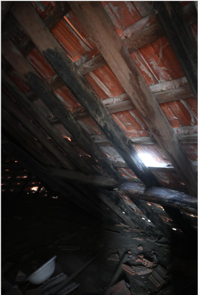
Imagem 79, anomalia nº 27 e 30
