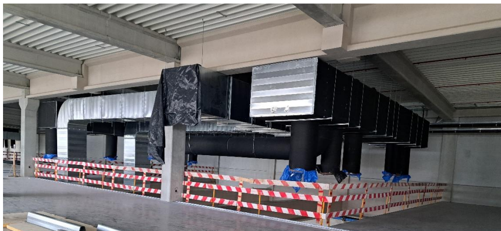
Figura 3.12 – Instalações de AVAC em zona de gradil no edifício da Produção
