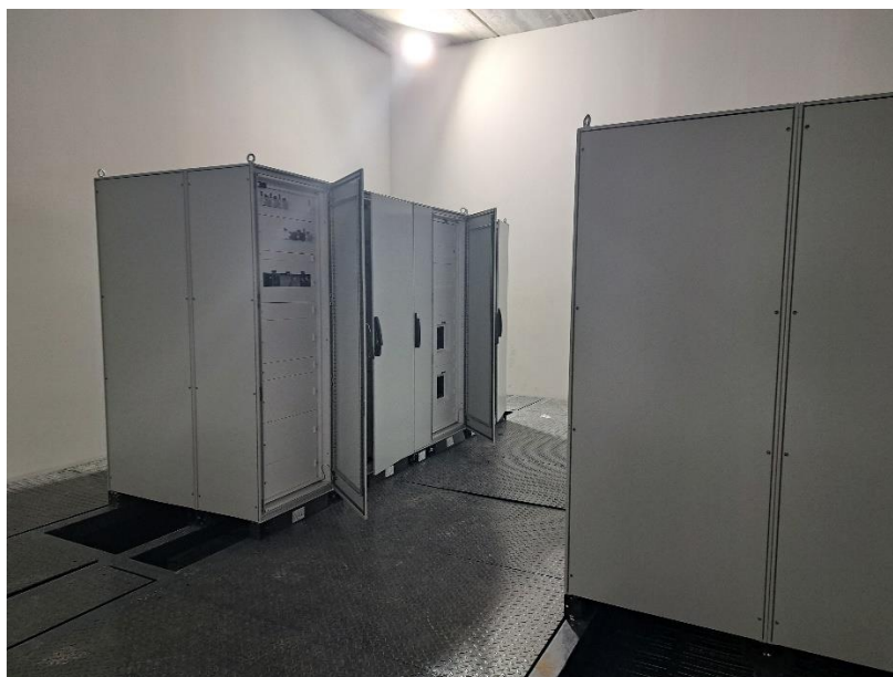
Figura 3.16 – Sala de quadros: quadros e piso técnico
