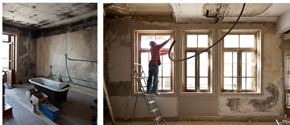
Fig.1 Estado de Conservação da Casa de Banho do Edifício na Rua Alexandre Braga; Fig.2 Estado de Conservação do Edifício na Rua Alexandre Braga;
