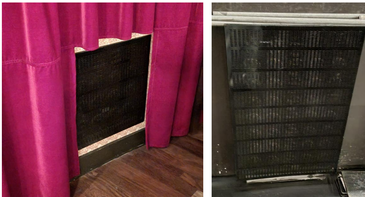
Figura 4.8 - Grelhas de insuflação: na zona da plateia e no palco [Fotos do autor].
