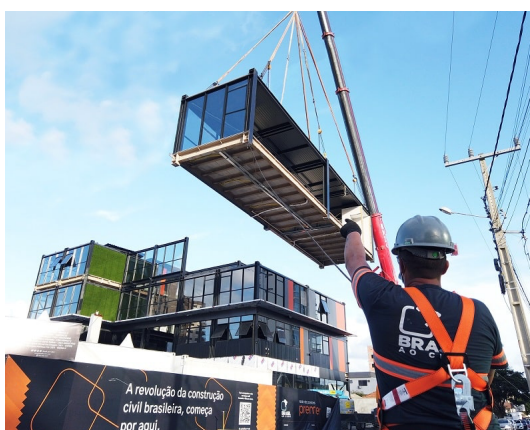
Figura 3 - Exemplo de módulo com estrutura em aço (Folha Vitoria, 2024)
