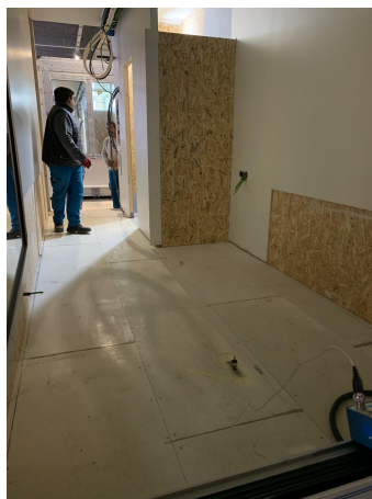
Figura 84 - Vista do interior do módulo completo durante um ensaio
