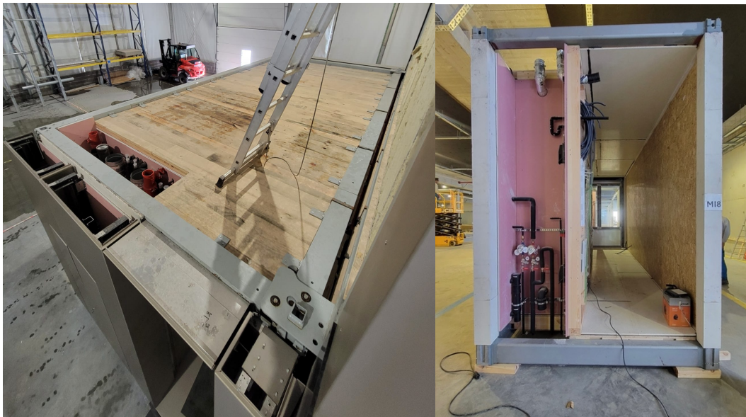
Figura 45 - Vista da área técnica no canto do módulo
