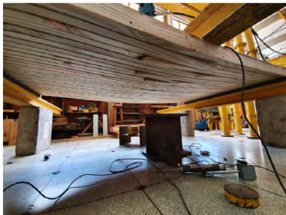
Figura 2. Placa de NLT rompida
