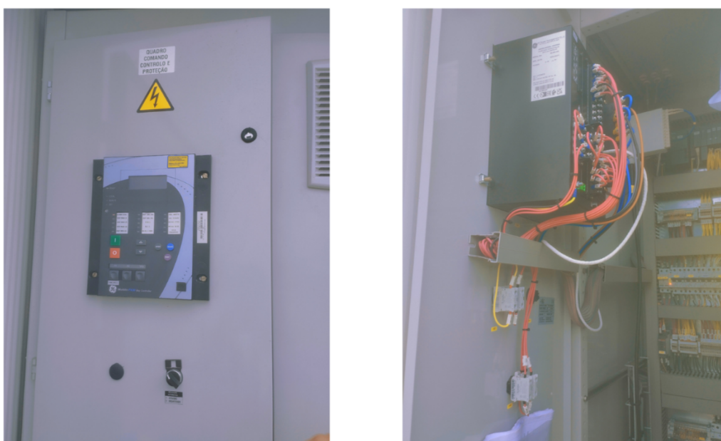
Figura 3.15: Vistas de um relé de interligação montado numa central fotovoltaica.
