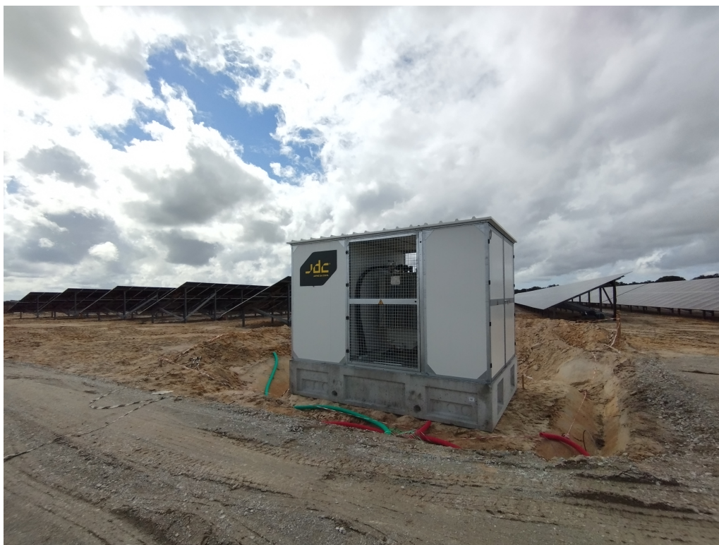
Figura 3.4: Posto de transformação desenvolvido pela Jayme da Costa.
