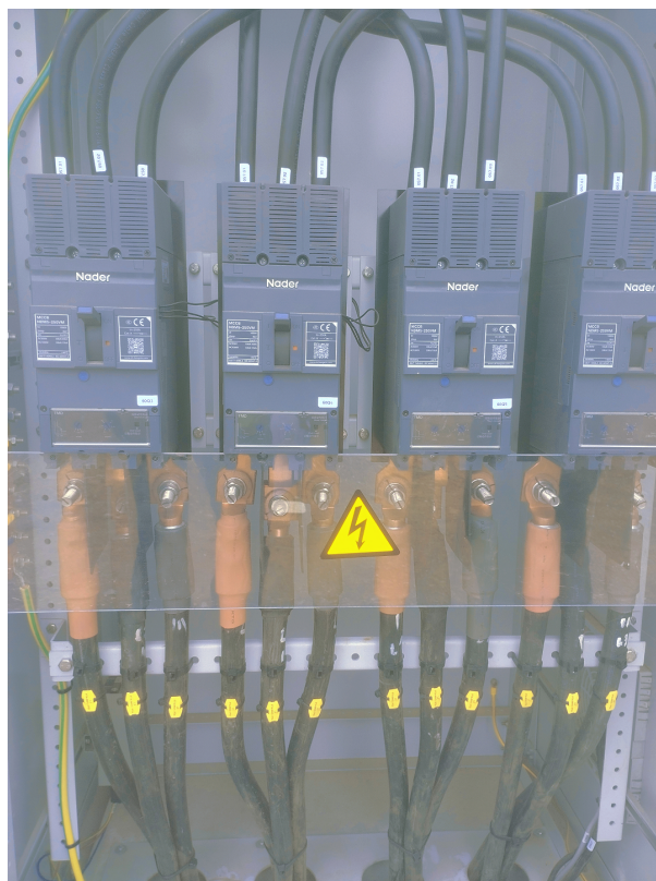
Figura 3.10: Disjuntores do QPI presente numa central fotovoltaica.
