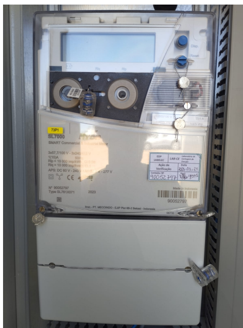
Figura 3.14: Contador de energia montado numa central fotovoltaica.
