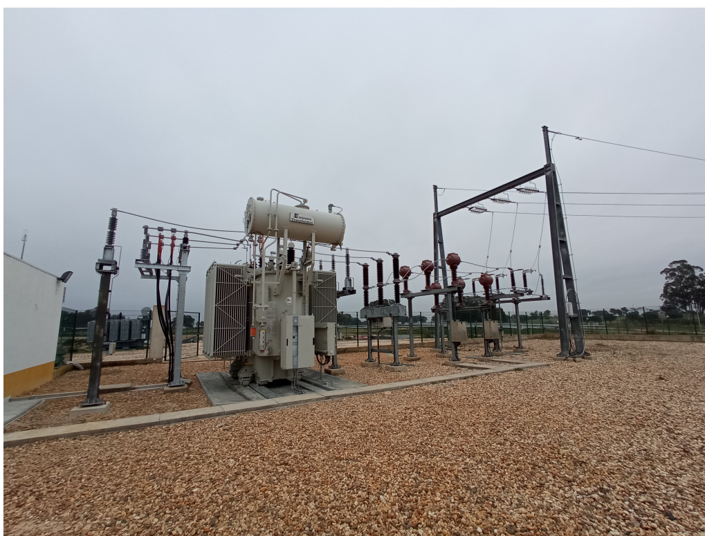
Figura 3.5: Subestação elétrica desenvolvida pela Jayme da Costa.
