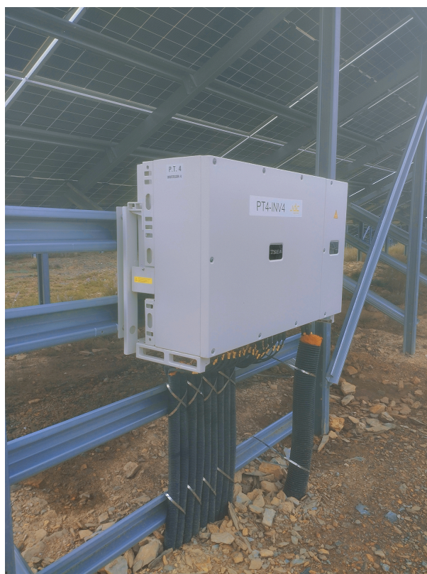
Figura 3.9: Inversor descentralizado presente numa central fotovoltaica.
