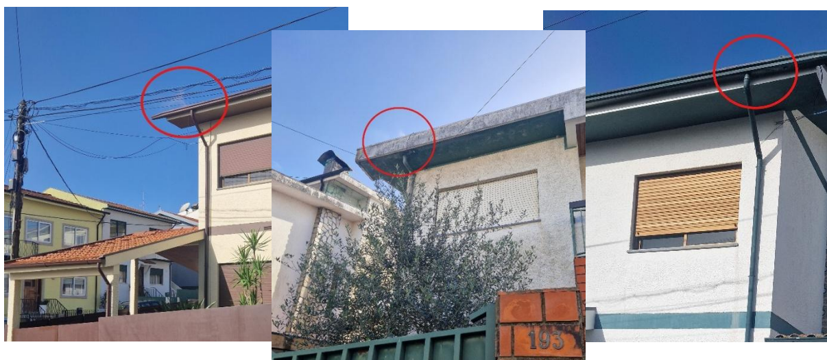
Figura 31 - Afluências indevidas identificadas na Rua dos Cravos, com recurso ao teste de fumos.
