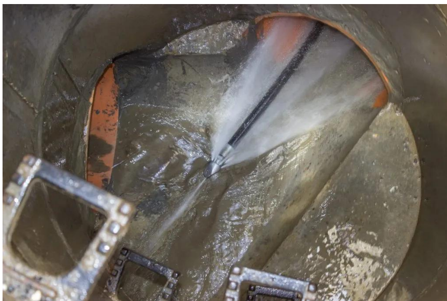
Figura 12 - Exemplo de um dispositivo de Jetting, em funcionamento. [2]
