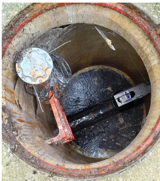
Figura 17 - Câmara de visita 1235114, com instalação de medidor de nível.
