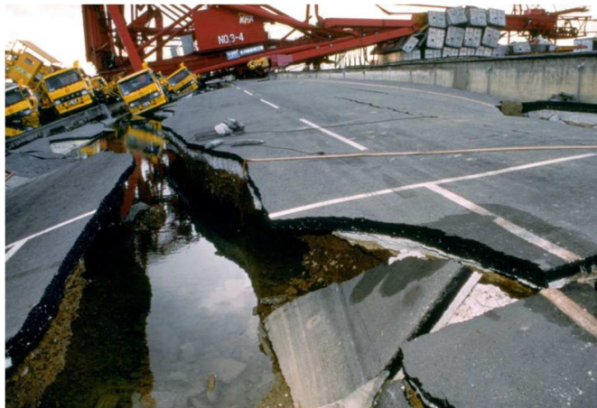
Fig. 49 – Liquefação por mobilidade cíclica, após terramoto no Japão, na região de Kobe (adaptado de https://education.nationalgeographic.org ).
