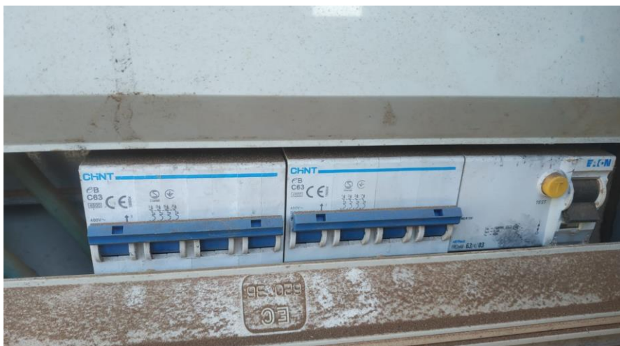
Disjuntores das linhas 1, 2 e 3
