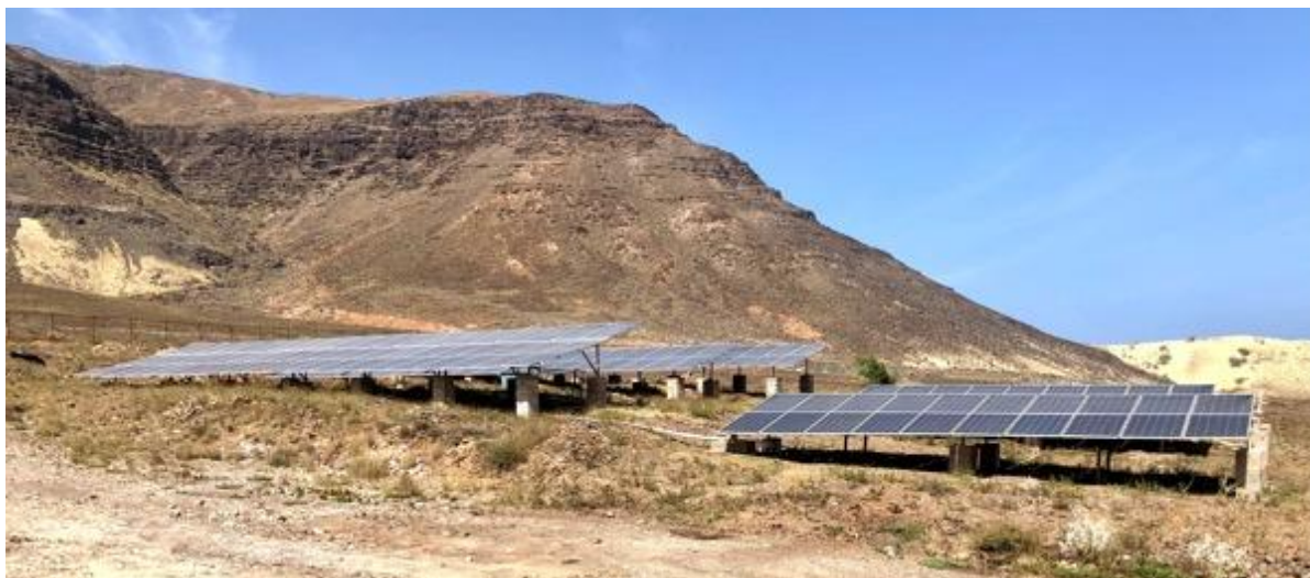
Fig. 8 - Painéis fotovoltaicos. (fotos do autor)
