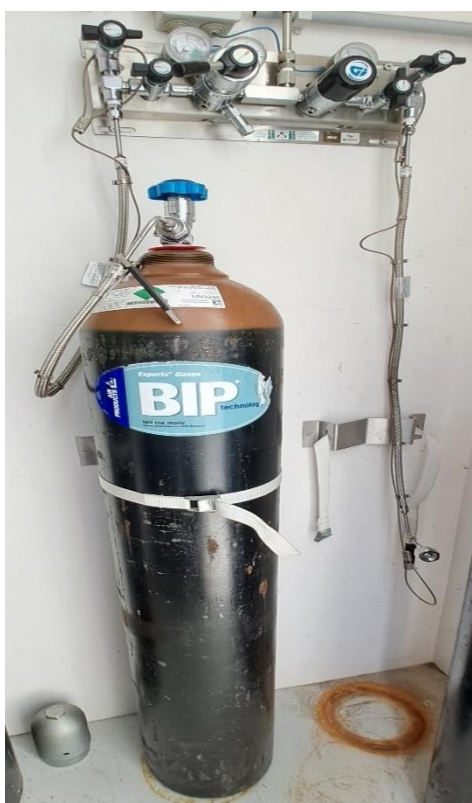
Figura 10: Garrafa de hélio (200 bar) equipada com redutor de caudal e manómetros
