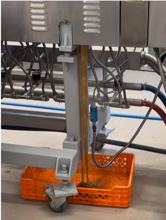
Figura 18 - Entupimento da extrusora.
