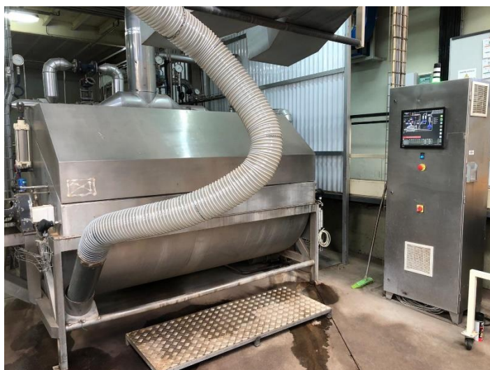
Figura 28. Máquina de lavação “Vinox 3” utilizada nos ensaios industriais.
