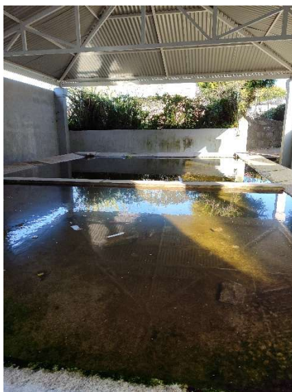
Figura 58 - Tanque Vinha da Bouça
