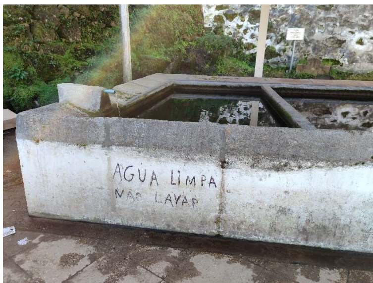
Figura 35 - Tanque dos lavadouros (instrução "água limpa não lavar")
