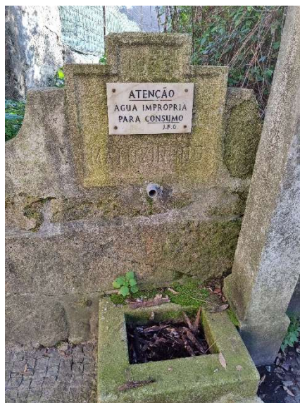
Figura 57- Tanque Parque da Lomba (pormenor placas sobrepostas)
