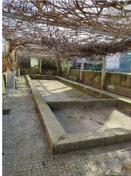
Figura 56- Tanque Parque da Lomba (panorâmica)
