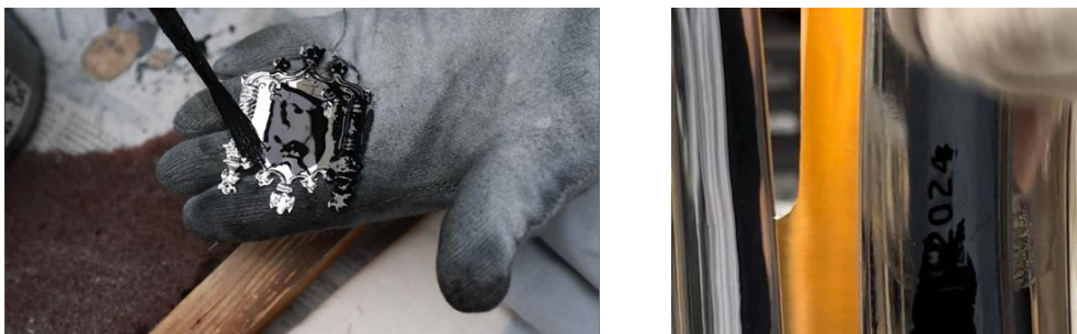
Figura 136- Aplicação de uma patine na superfície com auxílio de um pincel (esq.); Preenchimento de inscrição feita por gravação.
