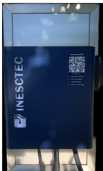
Figura 4.1: Unidade de carregamento EVSE nas instalações externa da INESC TEC (inescevse010)
