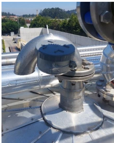
ED1 - Tanques de biodiesel
