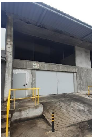
ED5-Abertura edifício (grelha norte de ventilação)
