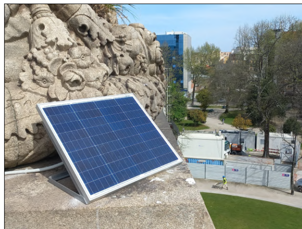
(b) Coletor fotovoltaico instalado
