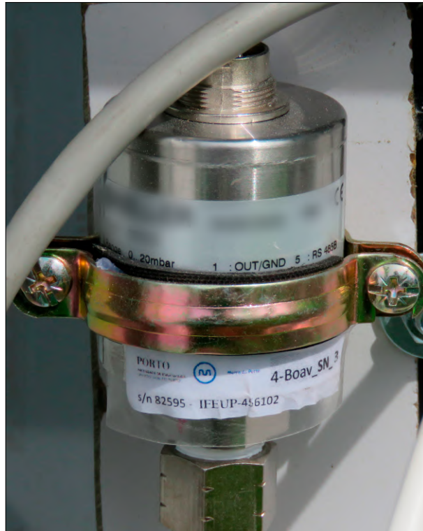
Figura 3.4: Sensor de Nível instalado in loco Fonte: Arêde et al. (2024)
