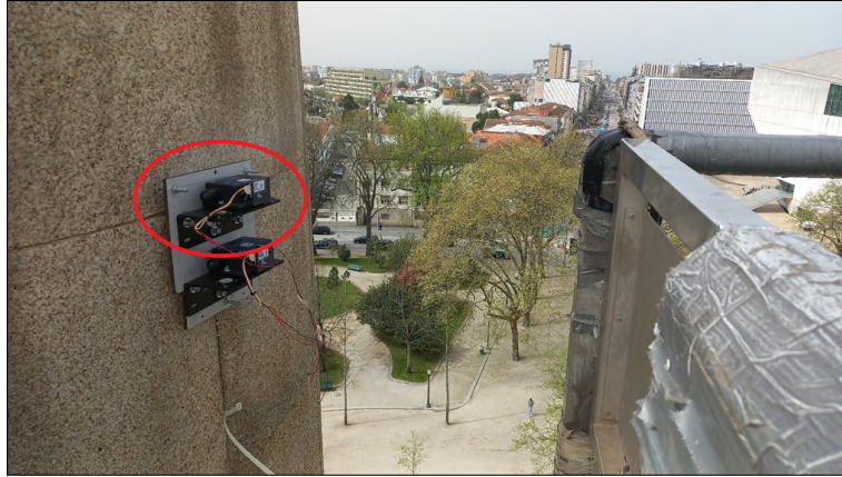
Figura 3.19: Instalação do Clinómetro Fonte: Arêde et al. (2024)
