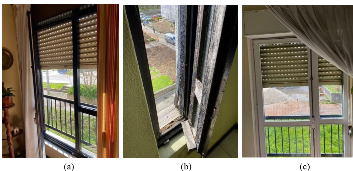
Figura 17 - Caixilharias da sala dos apartamentos estudados: (a) C-RC; (b) A-3º; (c) A-RC.
