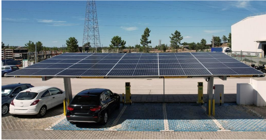
Figura 25 - Carport (Fonte: Greenvolt Next, 2023)
