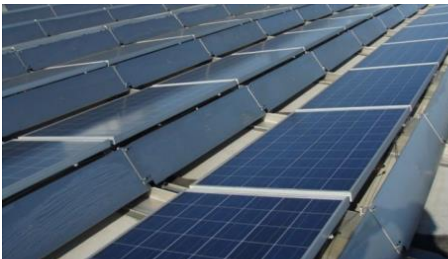
Figura 21 - Defletores de vento instalados nos lados mais altos dos painéis de cada fila (Fonte: FMDS 1-15:2024)
