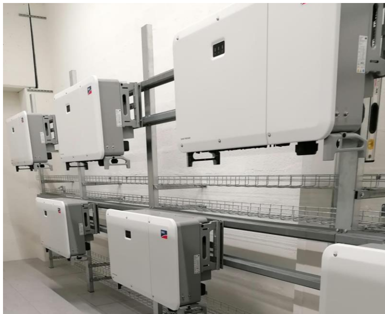
Figura 33 - Disposição dos inversores na sala técnica (Fonte: Própria)
