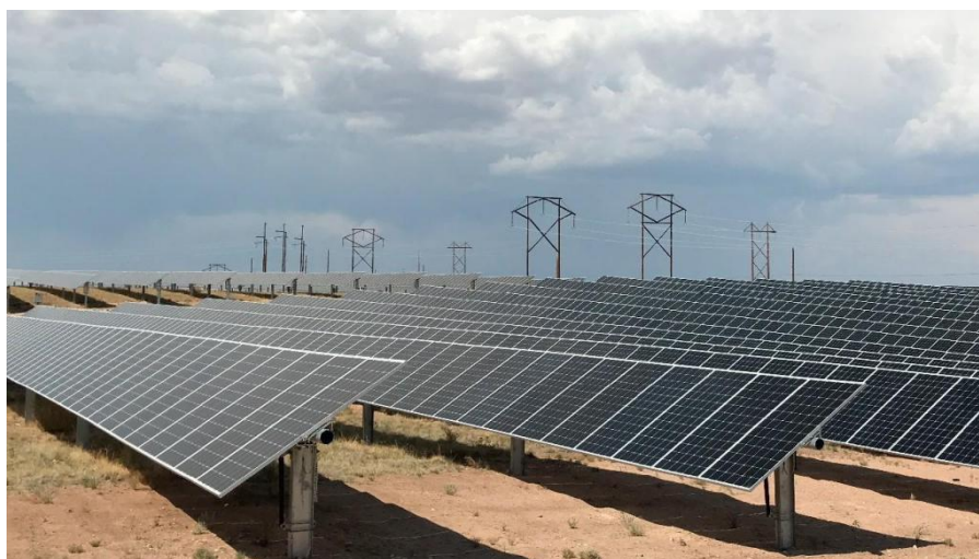
Figura 2 - Parque Fotovoltaico "Fernando Pessoa" (Fonte: CNN Portugal)
