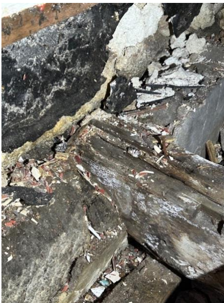
Legenda 4. 10 - Viga 4 (piso 2, zona 1, lado esquerdo), com presença de bolores.
