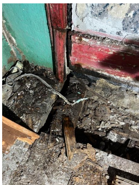
Legenda 4. 3 - Viga 1, piso 2, zona 1 (lado esquerdo), verifica-se infiltração de água.
