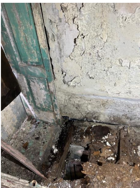
Legenda 4. 4 - Viga 1, piso 3, zona 1 (lado esquerdo), verifica-se infiltração de água.
