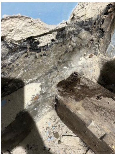
Legenda 4. 8 - Viga 1, piso 2, zona 2, com presença de fungos de podridão e perda de secção no apoio.
