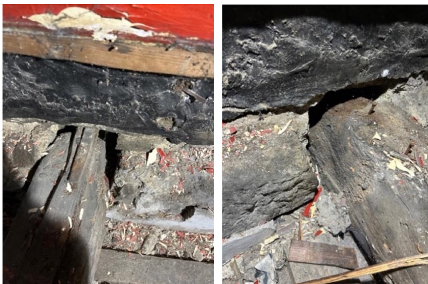
Legenda 4. 6 - Viga 5 e 6 (pisso 2, zona 1, lado esquerdo), com presença de fungos de podridão cúbica e perda de secção no apoio.
