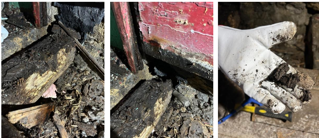
Legenda 4. 5 - Viga 1 (pisso 2, zona 1, lado esquerdo), com presença de fungos de podridão cúbica e perda de secção.
