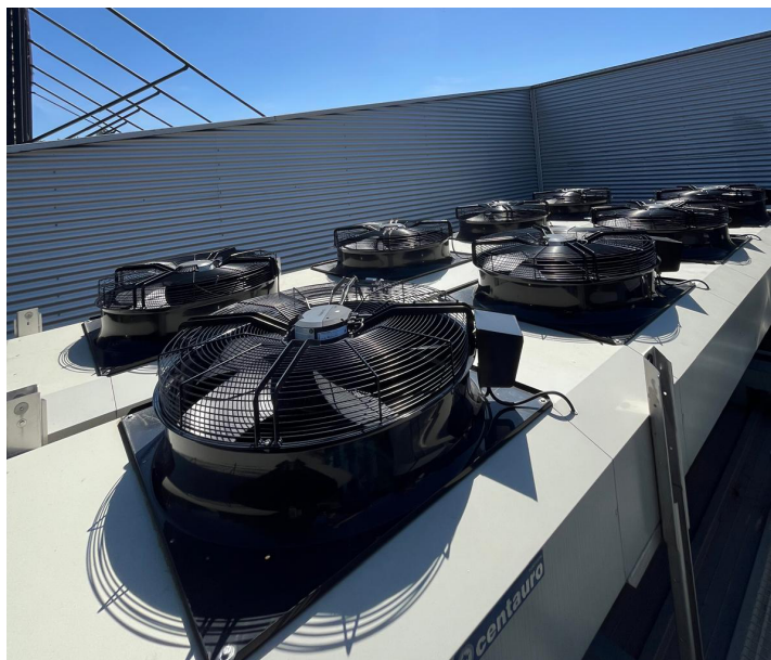
Figura 3.22: Gas cooler instalado no supermercado em estudo.
