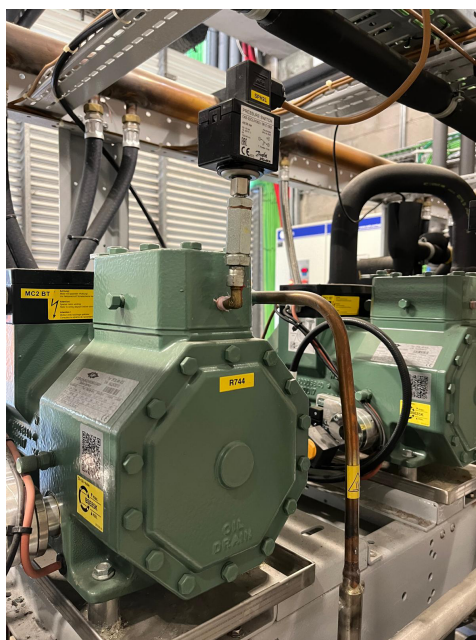
Figura 3.4: Compressor alternativo semi-hermético da Bitzer, utilizado na instalação em estudo.
