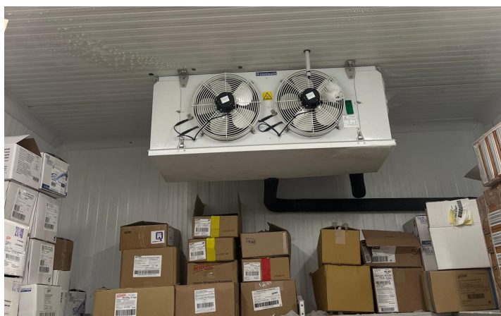
Figura 3.21: Evaporador instalado numa câmara de congelados.
