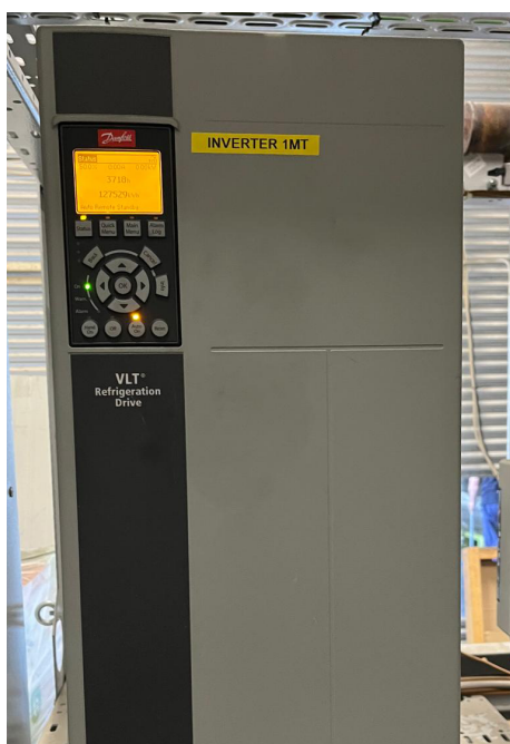
Figura 3.5: Inversor de um dos compressores MT.
