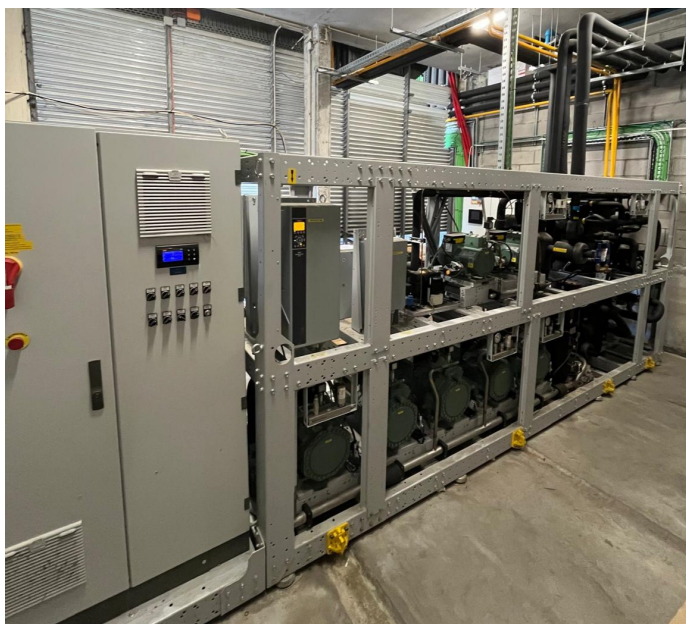
Figura 3.3: Central frigorífica instalada na loja.
