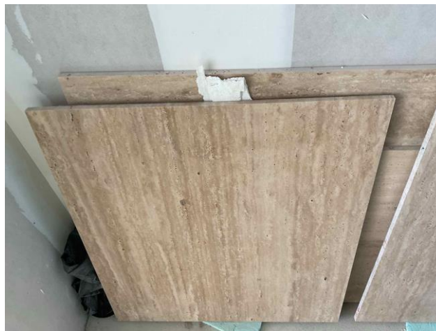
Figura 49- Mármore Travertino danificado (arestas boleadas)
