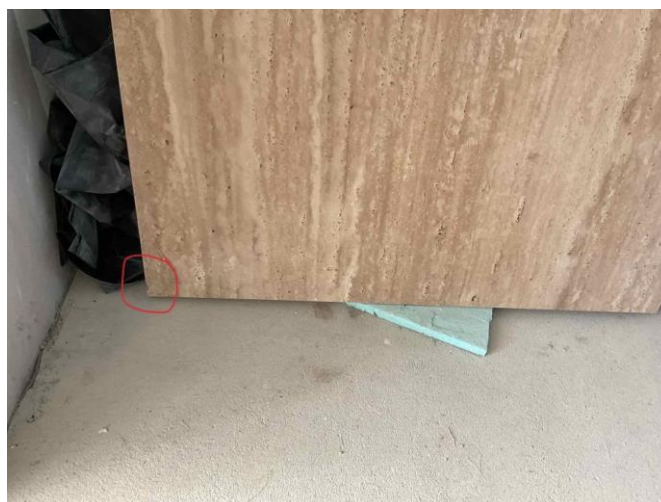
Figura 50- Mármore Travertino danificado (partido na aresta do canto)
