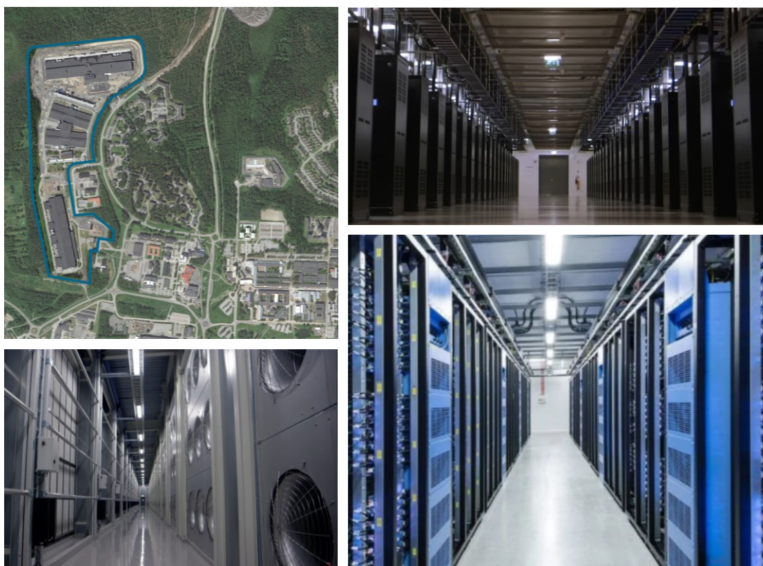
Figura 15 – Data Center da META na Suécia.
