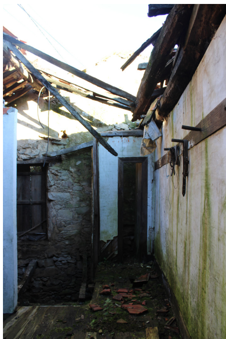
24 | Estado de degradação da Casa do Tear.
