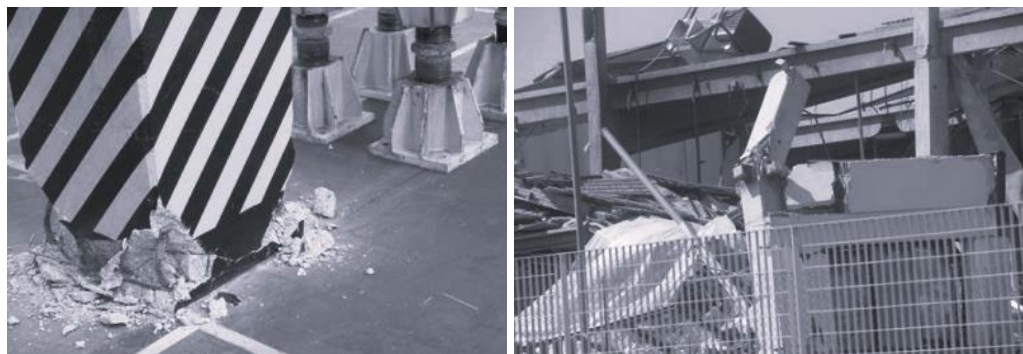
Fig. 3.1 - Danos em pilares pré-fabricados após a ocorrência de um sismo [20]
