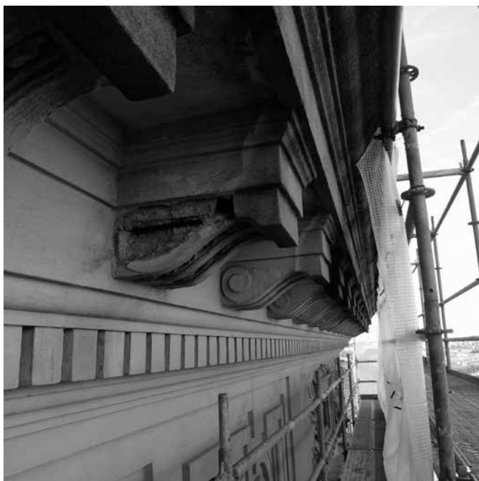
Fig. 29. Varões metálicos nas mísulas, 2013
