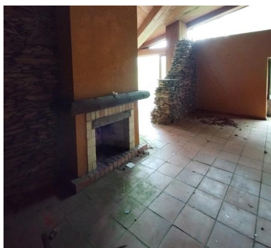
Figura 55. Estado atual do edificado. (Fonte: Autor)
