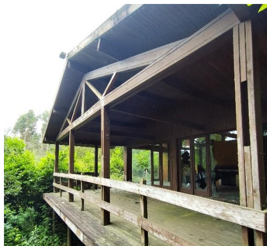
Figura 53. Estado atual do edificado. (Fonte: Autor)
