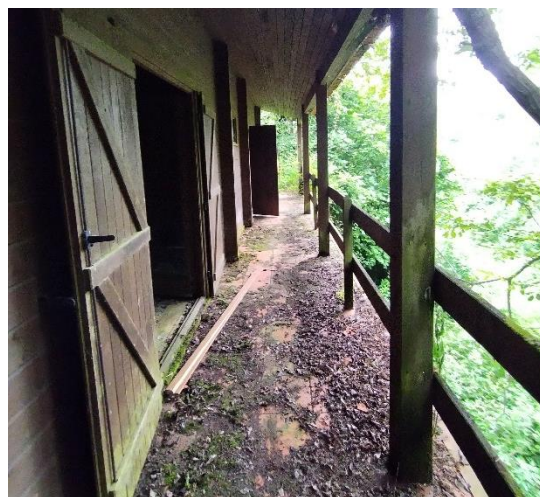
Figura 54. Estado atual do edificado. (Fonte: Autor)
