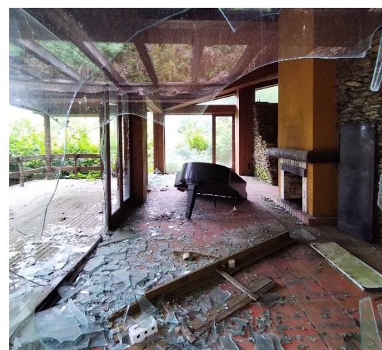
Figura 56. Estado atual do edificado. (Fonte: Autor)
