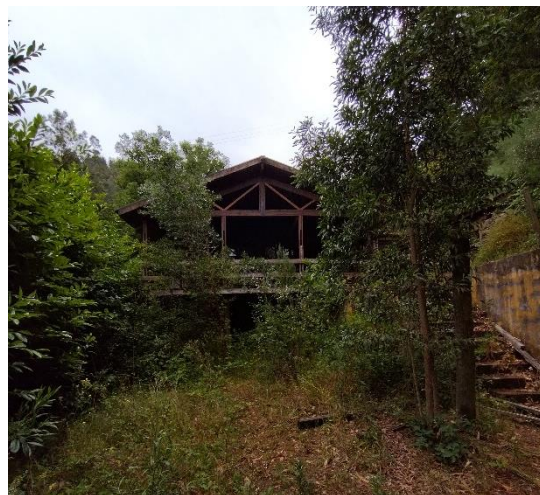
Figura 52. Estado atual do edificado. (Fonte: Autor)
