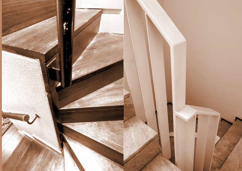
Fig. 75 Corrimão interrompido da escada do fogo no Lisbon Stone Block , Alberto Souza Oliveira, 2011
