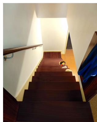
B.2.1 19. Escada Interior do Fogo
