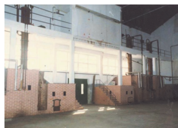
124 e 125. Caldeiras de destilação da Adegas cooperativas do Bombarral
