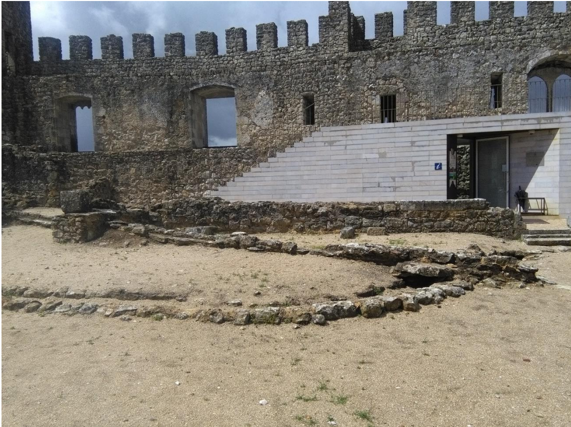
Foto 87 – Sistema de drenagem de água no pátio.
