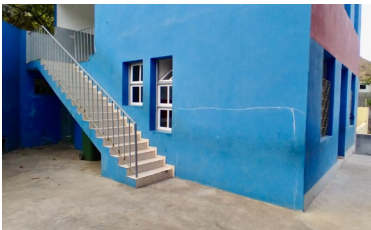
Fig. 122: A adaptação do sistema de acesso ao piso superior do segundo volume.
