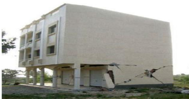
a) Danos em edifícios com distribuição irregular de paredes em planta e em altura (Corella, 2004)
